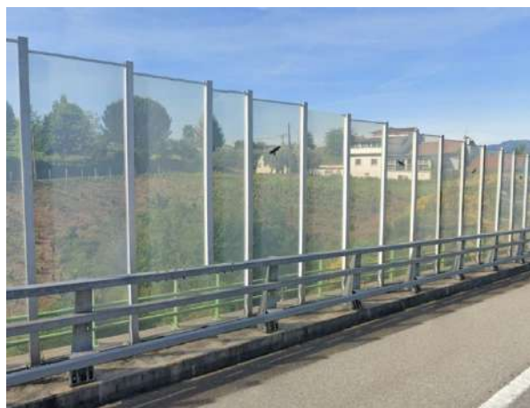
Figura 12: Barreira de Acrílico, localizada entre o km 93+872 e o km 93+938, no sentido crescente.
