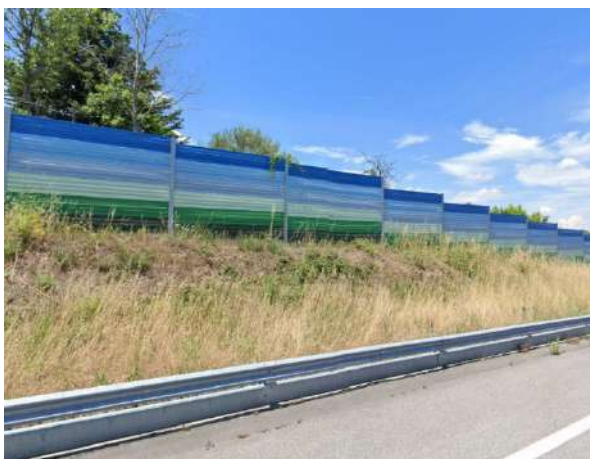
Figura 11: Barreira metálica, localizada entre o km 106+459 e o km 106+680, no sentido decrescente.
